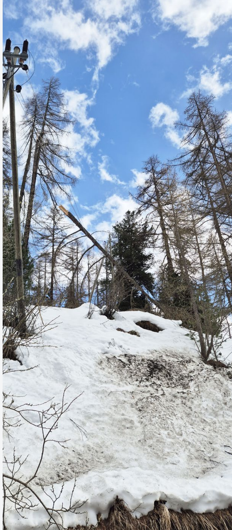
Beschädigte 20kV-Freileitung Richtung Sunnegga nach den starken Schneefällen vom April 2025
