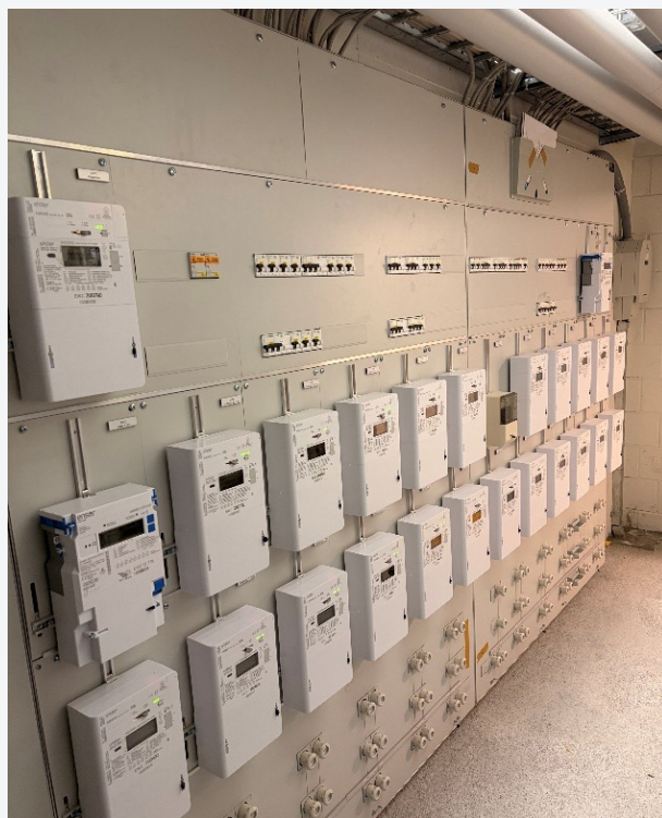
Abrechnungszähler in Hausverteilung
