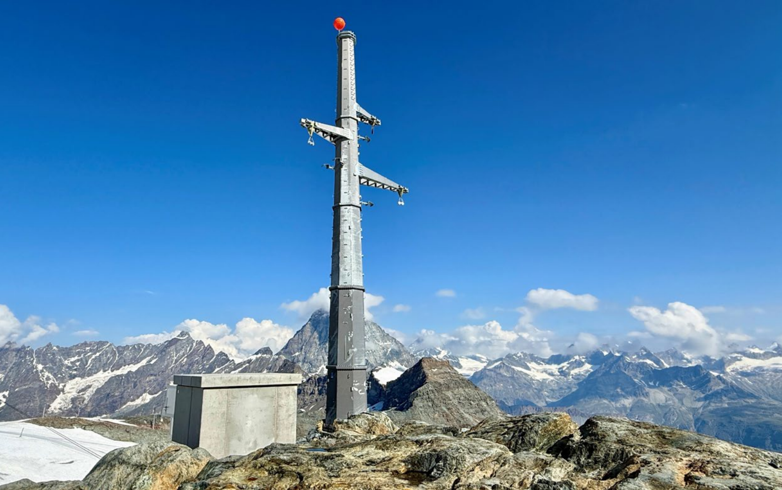
Neue Schaltstation für die Einspeisung der Plateau-Rosa-Lifte und Masten Nr. 11 auf 3438 m ü. M.
