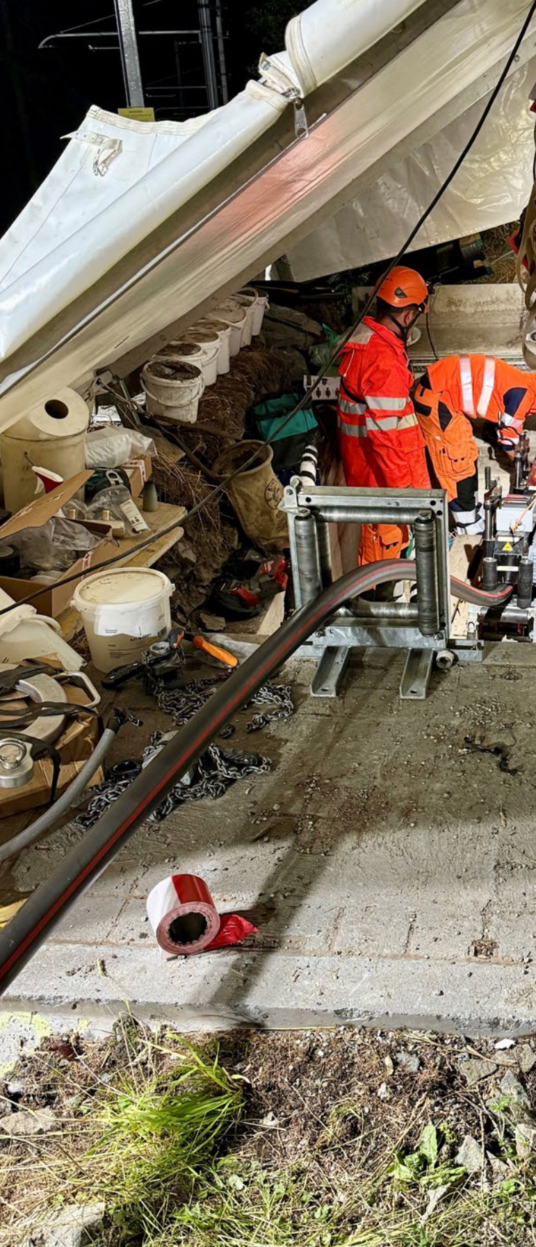
65kV-Kabelzug zwischen dem neuen UW Moos und dem UW Spiss (Leitertyp: XKDAIT 3 x 1 x 500 mm 2 )
