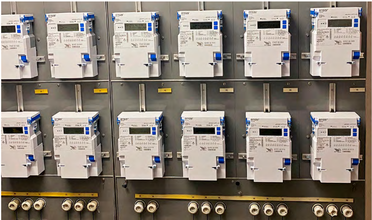
Abrechnungszähler in Hausverteilung
