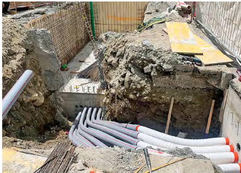
Kabeleinführungen in Neubau TS Schlummatte
