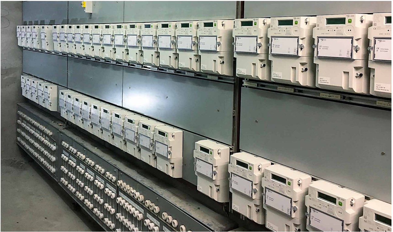
Abrechnungszähler in Hausverteilung
