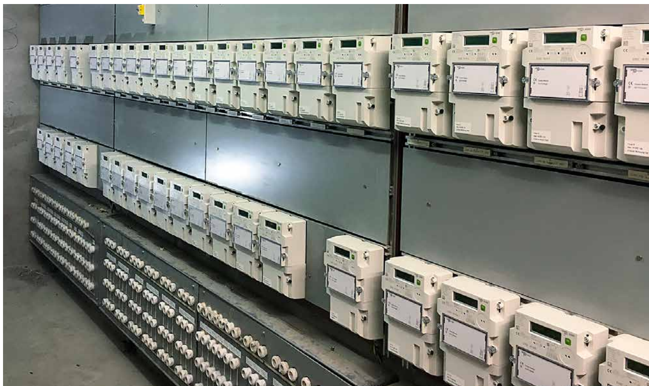
Abrechnungszähler in Hausverteilung
