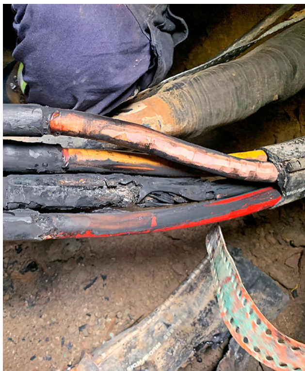
Schadenfall: Kurzschluss an 400 Volt Kabelmuffe
