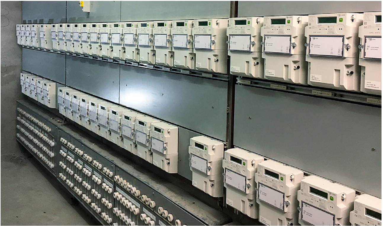
Abrechnungszähler in Hausverteilung
