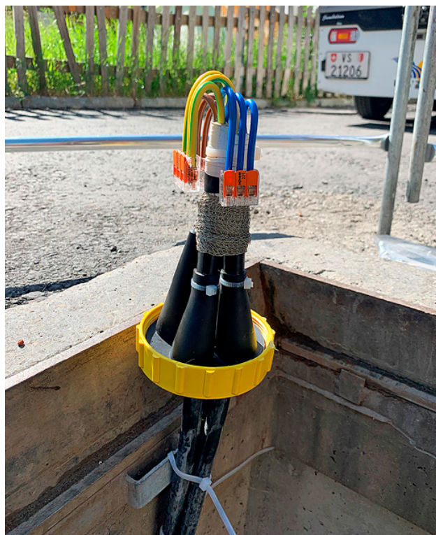
Kabelmuffe für öffentliche Beleuchtung
