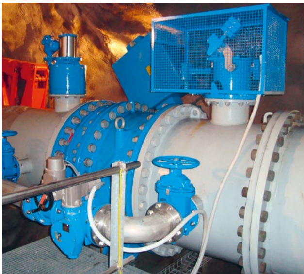
Druckleitung mit Sicherheitseinrichtungen: Apparetekammer
