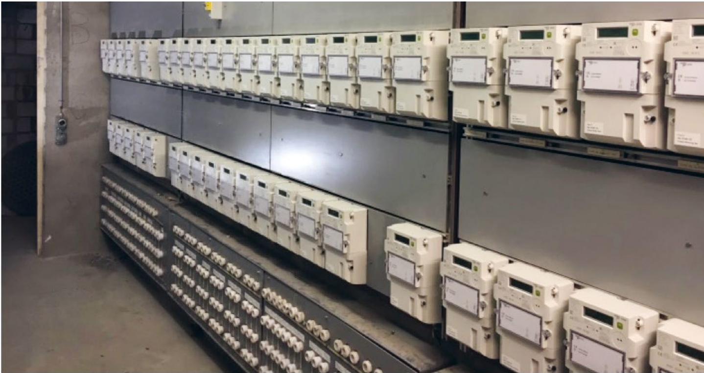
Abrechnungszähler in Hausverteilung
