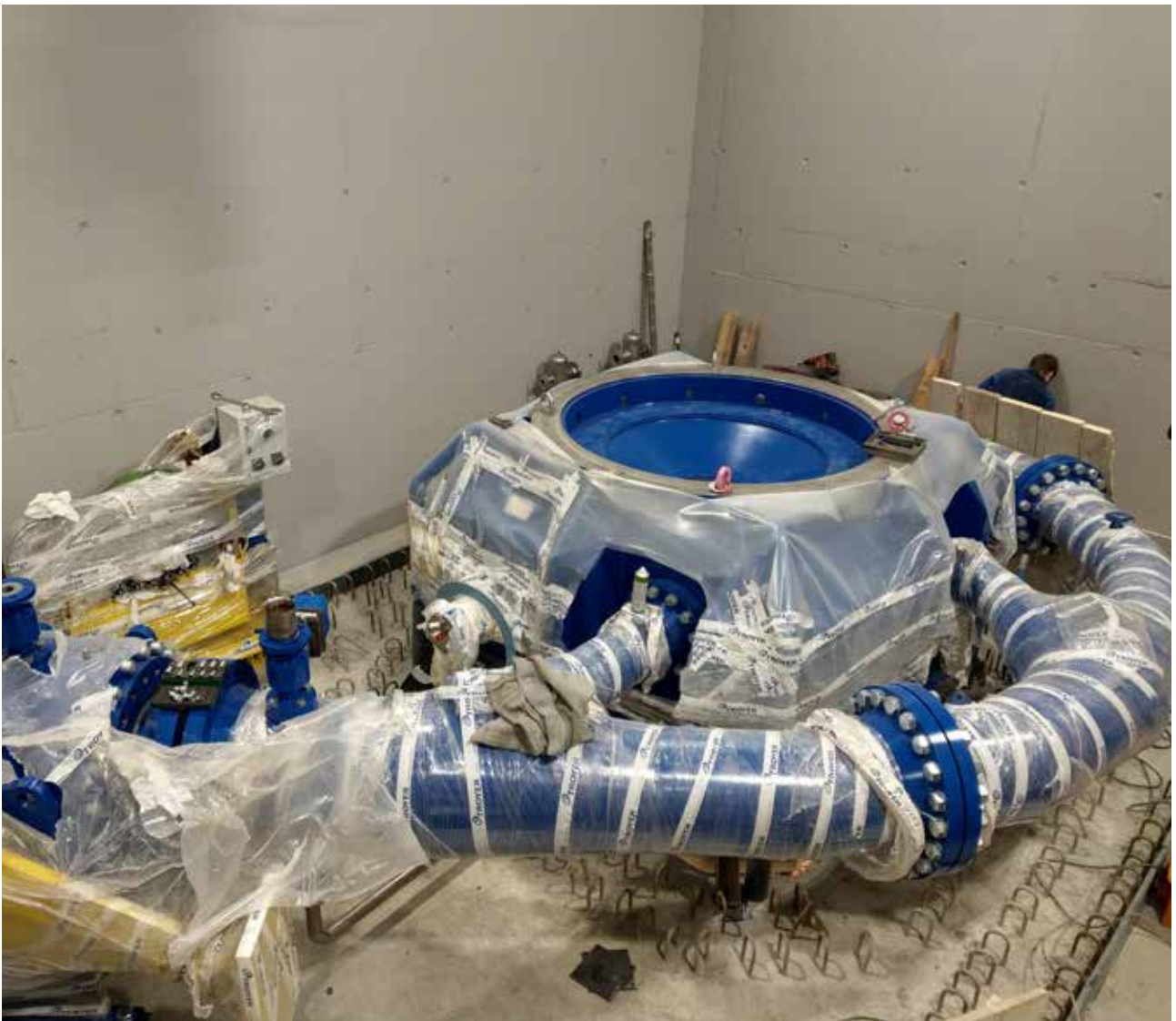
Turbine, Kugelschieber und Hydraulikaggregat platziert
