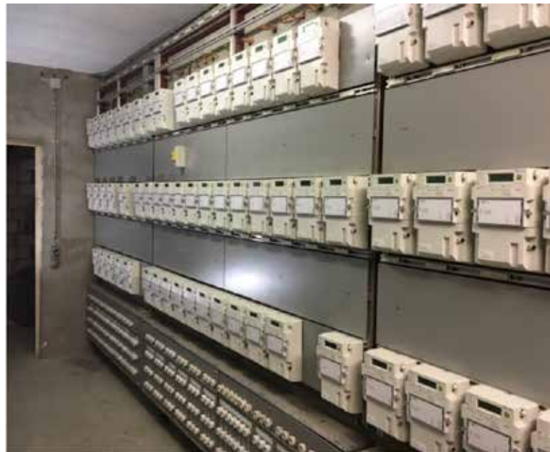
Abrechnungszähler in Hausverteilung
