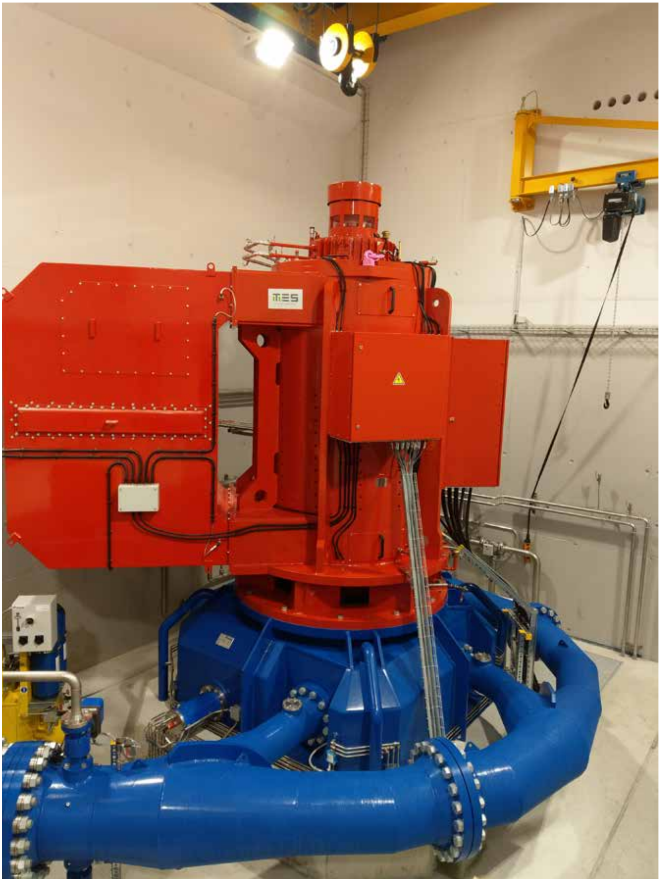
Maschinengruppe fertig angeschlossen und betriebsbereit
