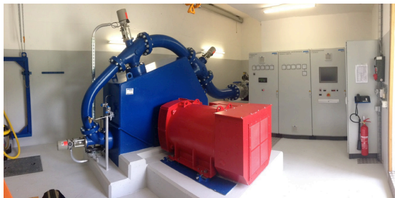
Turbine (blau) und Generator (rot) des KW Mossjese
