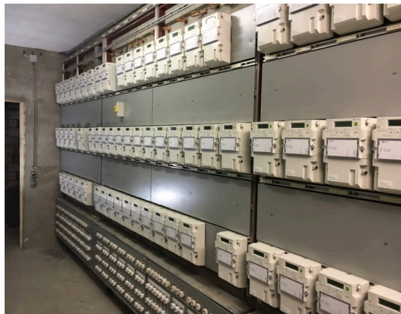
Abrechnungszähler in Hausverteilung
