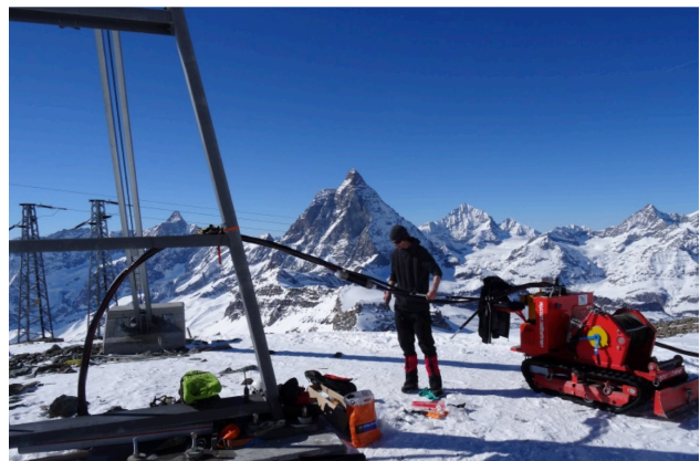
Plateau Rosa: Anschluss Kabelleitung Klein Matterhorn
