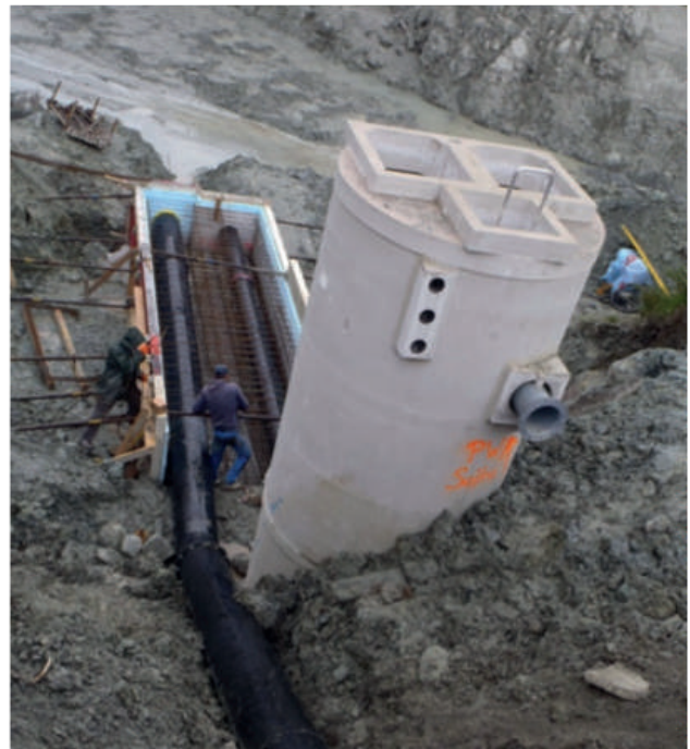
Rohr links: Leitung Wasserrückführung in den Mossjensee nach Turbinierung Rechter Teil: Fassungsanlage mit Schacht Vorpumpe Beschneigungsanlage
