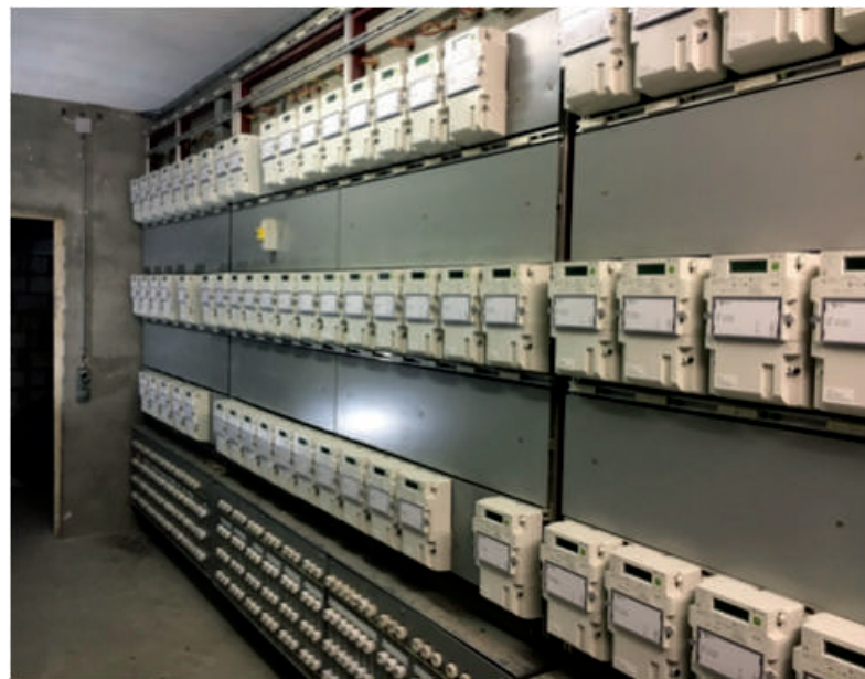
Abrechnungszähler in Hausverteilung
