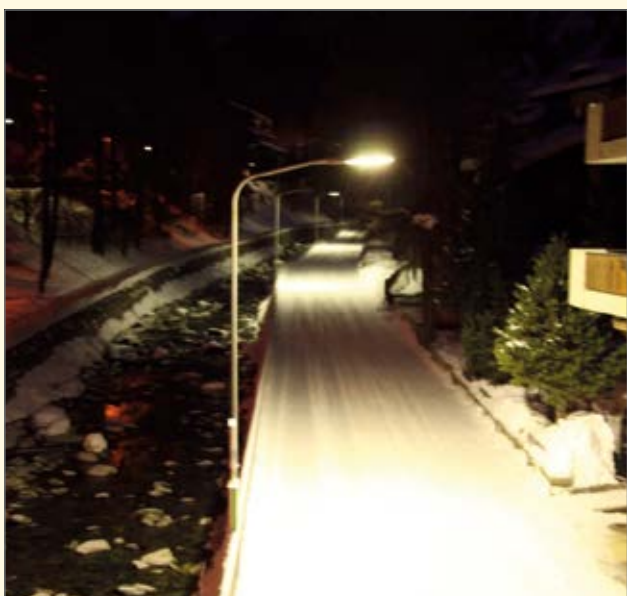
Beleuchtung «alt» HQL 2x250Watt • Dunkle Abschnitte zwischen Leuchtpunkten • Streulicht neben der Strasse
