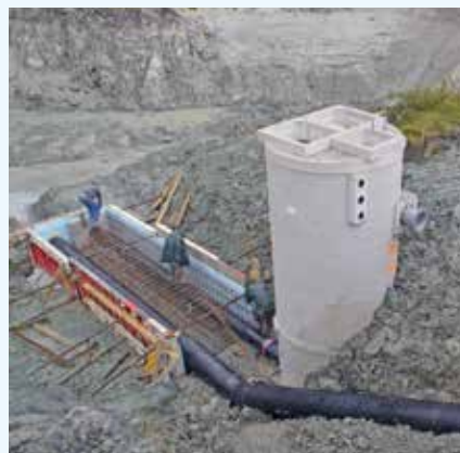
Fassung Beschneigungsanlage (Das Rohr im Vordergrund dient der Wasserrückgabe des geplanten KW Mossjesees)
