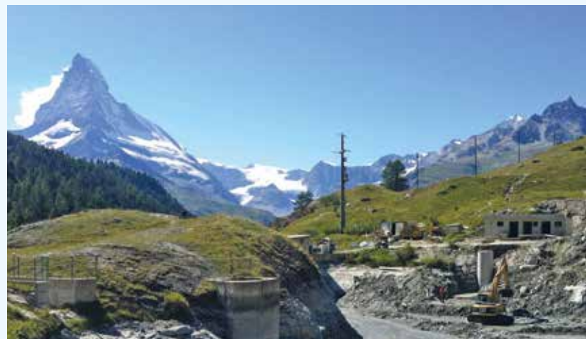
Bauarbeiten für Fassung und Pumpwerk Beschneigung; (neue „TS Mossjensee“ im rechten Gebäudeteil)
