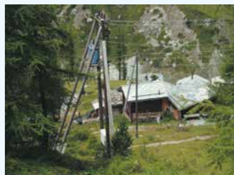
Alter Stangentrafo Stafelalpe
