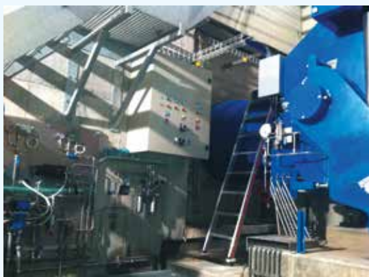
KW Mutt, Steuerung Kugelschieber (links)
