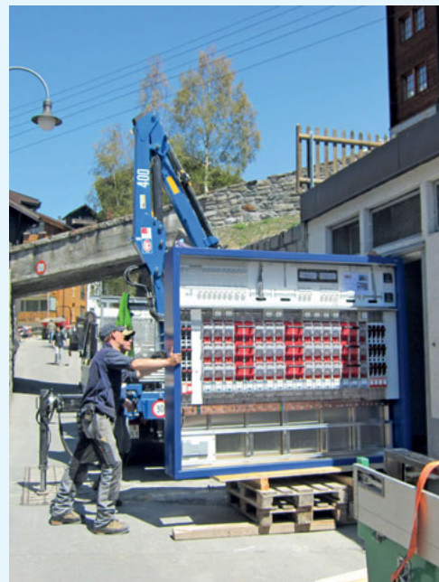
TS Steinmatte; Neue Niederspannungsverteilung
