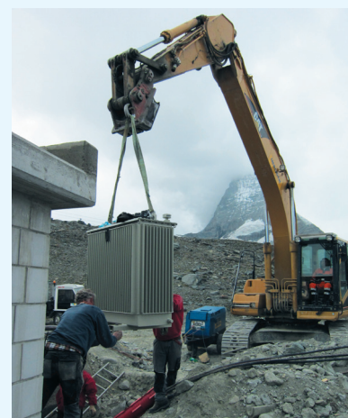
Transport Transformator «TS Snöberbar»
