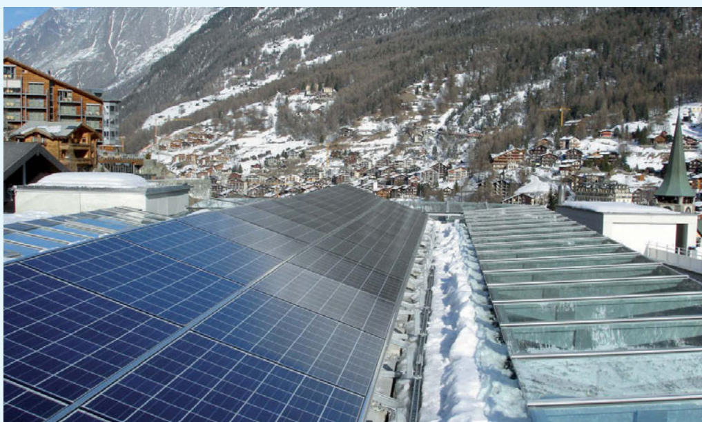
Photovoltaikanlage auf Verwaltungsgebäude/Schulhaus Trift
