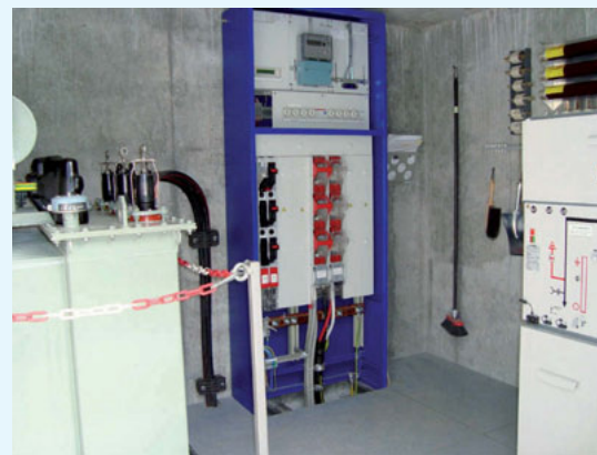
Ausrüstung „TS Zmutt“ links: Transformator 160kVA mitte: Niederspannungsverteilung rechts: Mittelspannungsanlage
